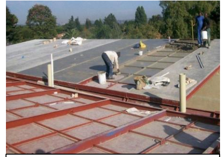
اسطح اسقف معزولة حرارياً
