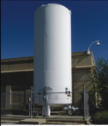
خزانات تبريد للعزل (مطلوب براتلي بيرل خاص من الدرجة 45)
