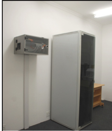
غرفة جهاز خادم الحاسوب مليسة بمادة براتلي بيرل للتقليل من متطلبات الطاقة للتبريد.
