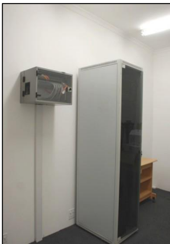
غرفة جهاز خادم الحاسوب مليسة بمادة تودو بيرلايت للتقليل من متطلبات الطاقة للتبريد.
