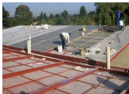
اسطح اسقف معزولة حرارياً
